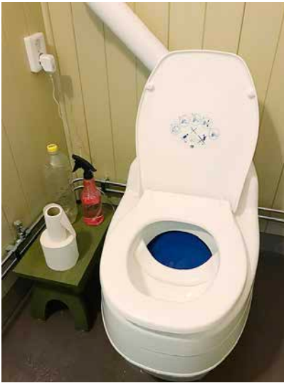
Separett Villa fungerar bra för en familj i permanent-boende. Det blå insynsskyddet fjädrar åt sidan när man sätter sig. Urinen leds i rör genom ytterväggen till en nedgrävd tank. Bildning av urinsten förebyggs genom att efter varje användning spola med vatten med lite ättika i (pet-flaskan i bild).
